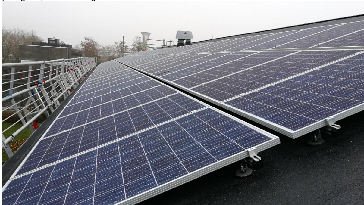
Byens største solcelleanlæg sættes op på DIK-kollegiet
