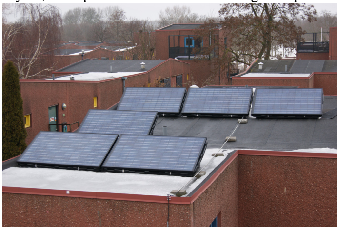
Solcellerne gør Høkerlængen 2 til et Plus-energi-hus
