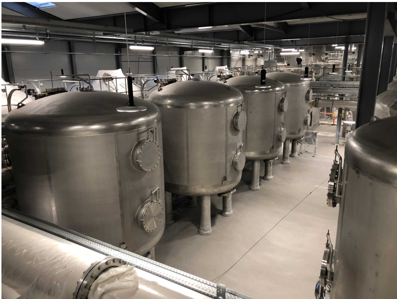
Vandet håndteres i store ståltanke på Thorsbro vandværk, hvor Albertslund Syd får vand fra.
